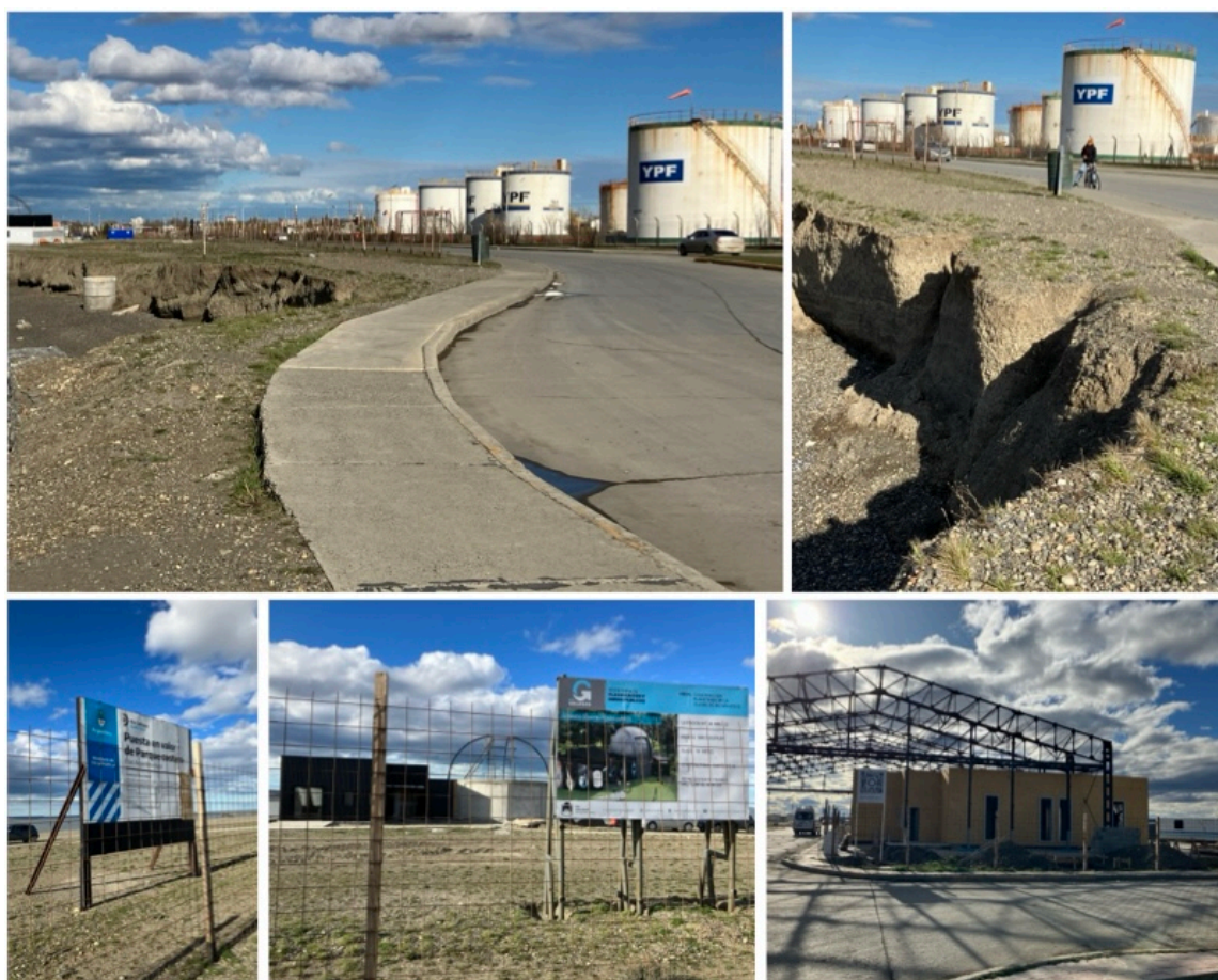
Figura 5. Ejemplo de erosión retrocedente y afectación de la avenida costanera; construcciones actuales realizadas sobre el borde costero.
